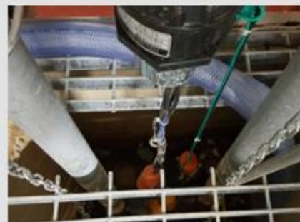
빌딩 - 기계실 침수
